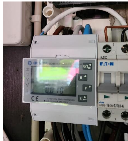
Figur 1.8 Smartmeter monteret i tavle Kilde: Privat foto
