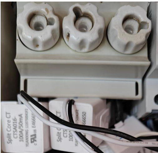
Figur 1.7 CT-coils monteret på gruppe Kilde: Privat foto
